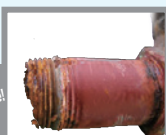
老朽化した金属管
