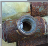
老朽化した金属管
